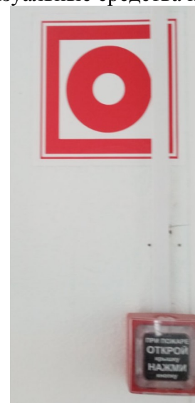
Фото №16 Визуальные средства путей эвакуации
